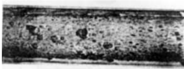
Рис. 4.19. Вид внутренней поверхности трубы, поврежденной вследствие кислородной коррозии
