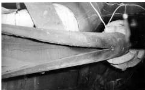
Рис. 6.28. Общий вид разрушенного гиба
