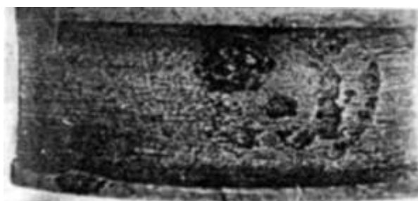
Рис. 4.22. Вид внутренней поверхности трубы поврежденной вследствие подшламовой коррозии
