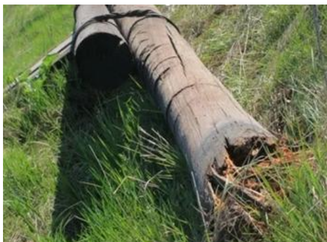
Рисунок 2. Загнивание опоры ЛЭП
